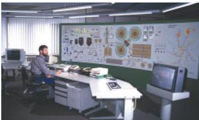
Die Hauptschaltwarte – Kommandozone der Kläranlage
