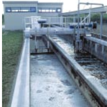
Der belüftete Sand- und Fettfang – das zweite „Sieb“ in der Mechanik
