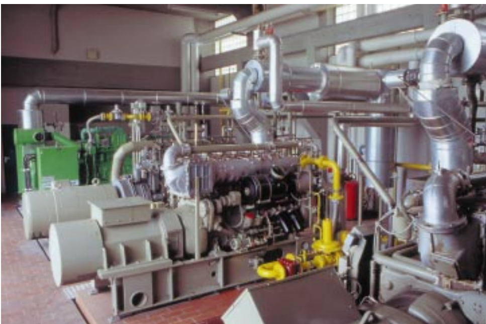
Das Blockheizkraftwerk – das Kraftwerk in der Kläranlage. Täglicher Gewinn: 3400 kWh Strom
